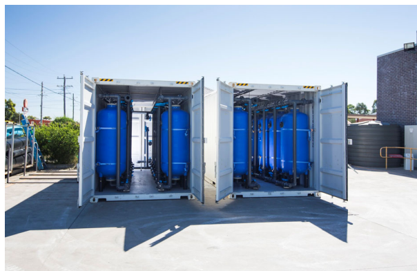
オーストラリアの空港にあるランクセスのイオン交換樹脂を用いた移動式コンテナの PFAS 汚染水浄化設備(写真:Haldon Industries)
