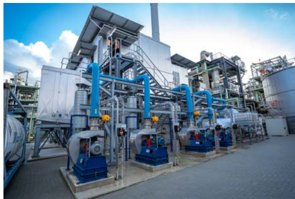
ランクセスはアントワープの新しい亜酸化窒素還元プラントにおいて、笑気ガスを1,000°Cで窒素と酸素に分解し、完全に中和します。(写真:ランクセス AG)
